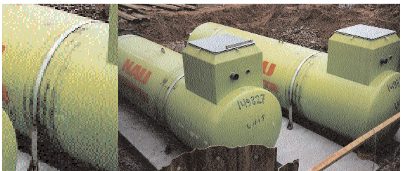
Tanksicherung mit Stahlbändern
